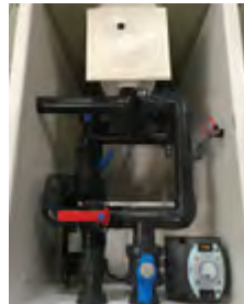
Bypass Stellungen mit Nutzung einer Wärmepumpe.
